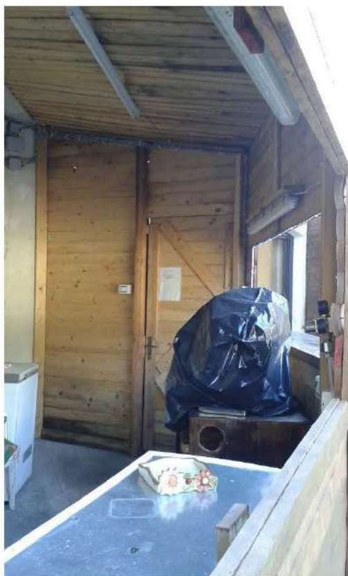
Foto 56: Piano rialzato: Strutture in legno per l'ampliamento abusivo realizzato
