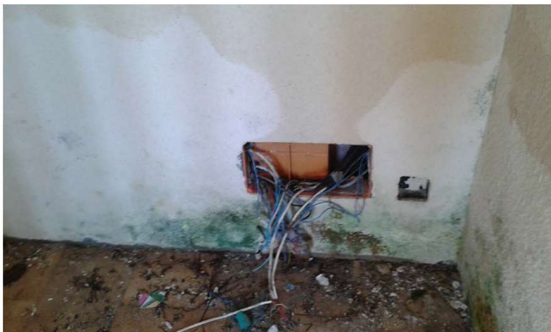
Foto 60: La parte impiantistica necessita di opportune manutenzioni
