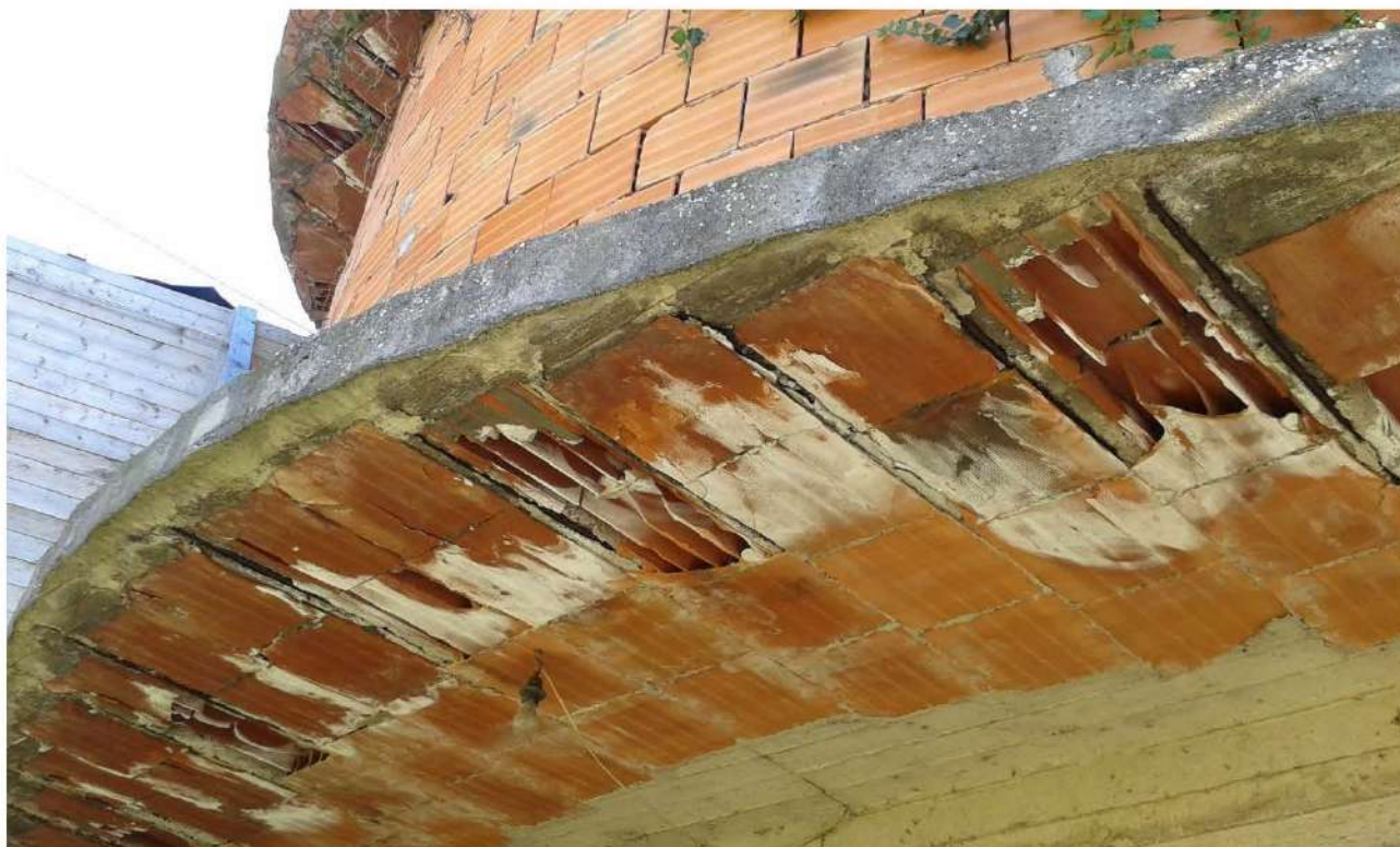
Foto 50: Piano rialzato: Alcuni ballatoi risentono di scarsa manutenzione e di assenza dei lavori di completamento
