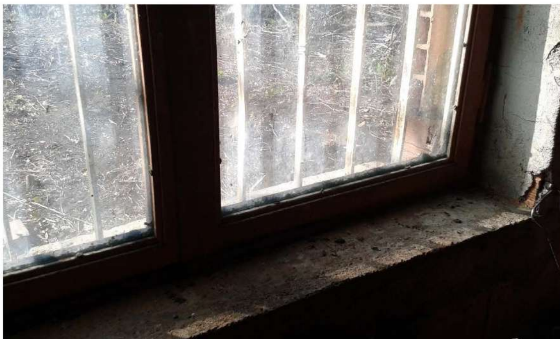
Foto 48: Piano seminterrato: Finestra in scarse condizioni di manutenzione
