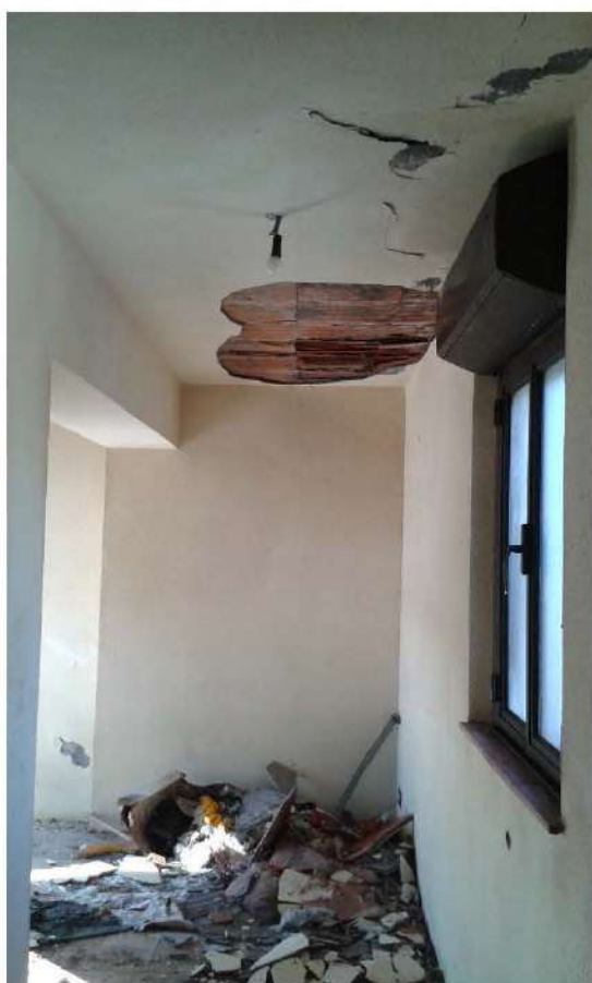
Foto 51: Piano soffitta: I solai di copertura risentono di copiose infiltrazioni meteoriche (si rilevano processi di sfondellamento dei solai con distacchi di intonaci e parti di pignatte)
