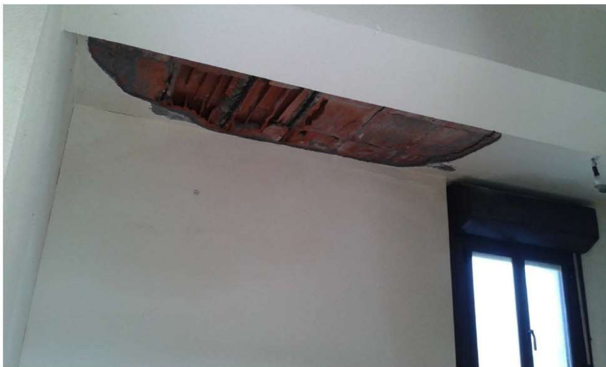
Foto 44: Piano soffitta: Condizioni precarie del solaio del locale sgombero
