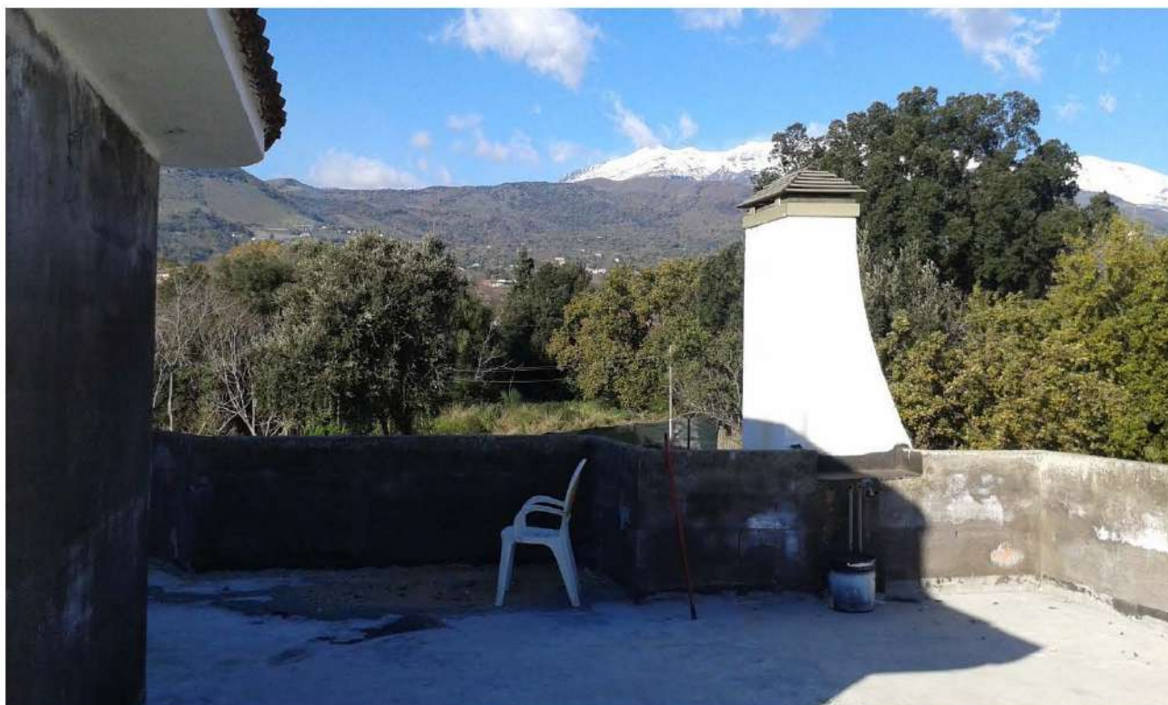
Foto 52: Piano soffitta: Terrazza non rifinita (assenza di pavimento e opere di completamento)
