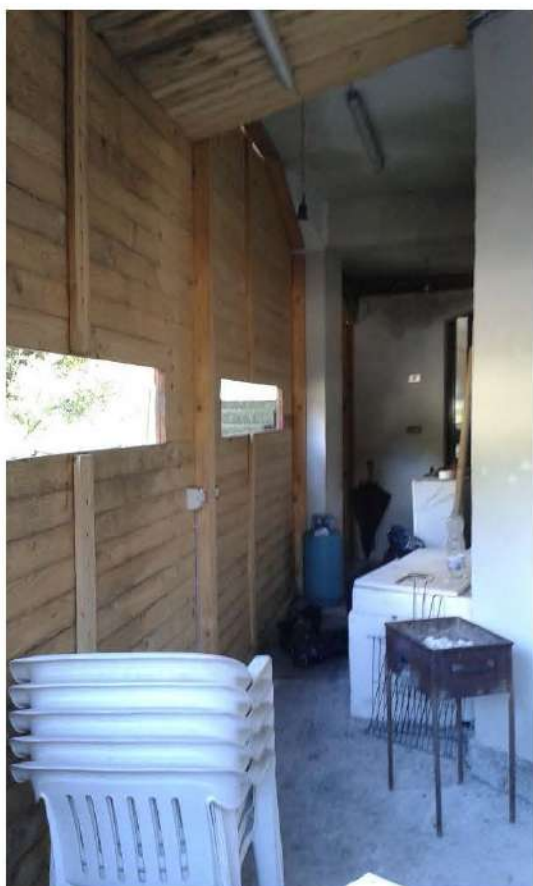
Foto 55: Piano rialzato: Strutture in legno per l'ampliamento abusivo realizzato
