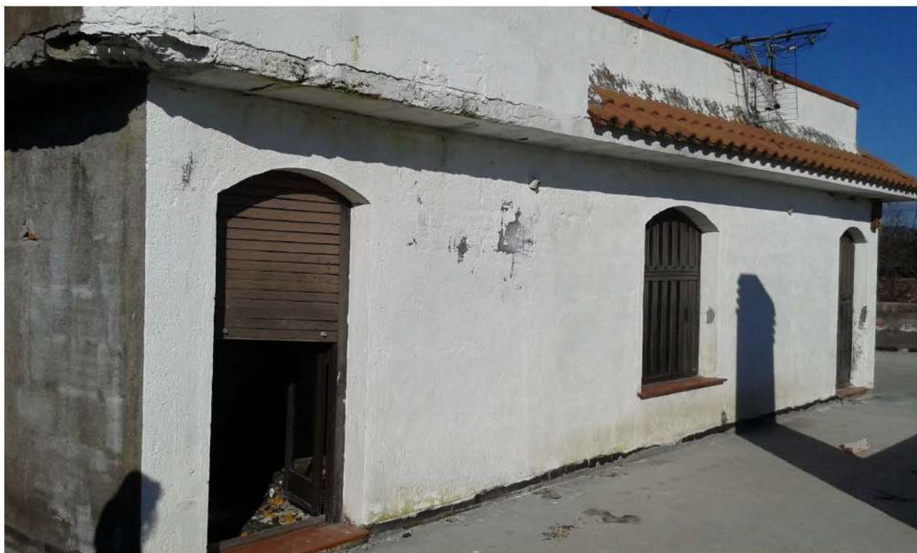
Foto 54: Piano soffitta: Si notano le insufficienti condizioni di manutenzione e di finiture esterne
