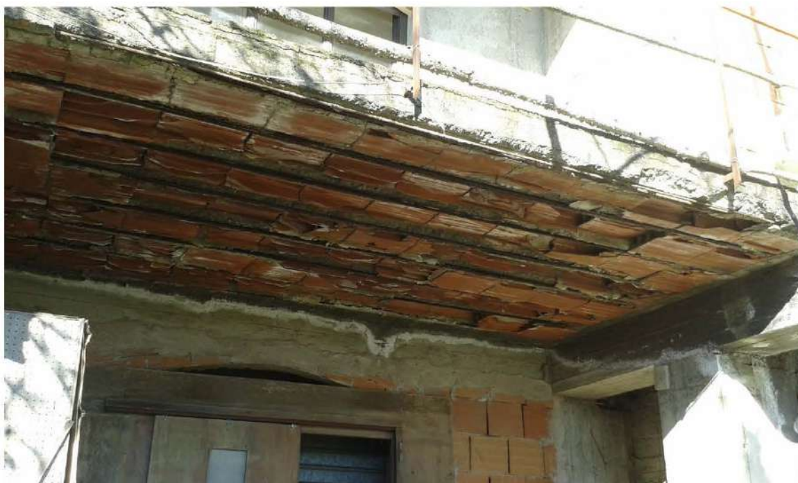
Foto 61: Piano rialzato: diversi ballatoi risentono di scarsa manutenzione e di assenza dei lavori di completamento
