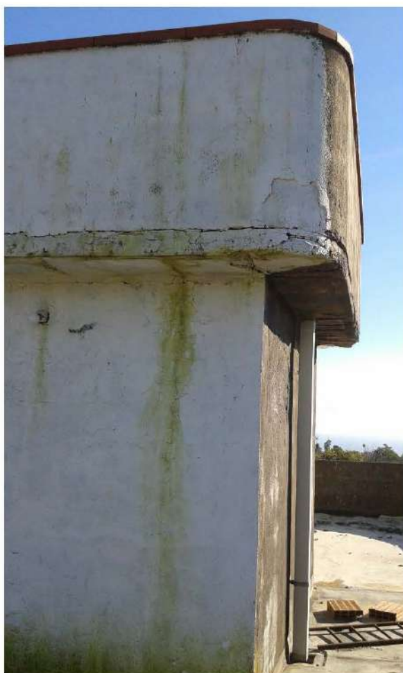
Foto 53: Piano soffitta: Altro segno di sofferenza dei solai di copertura per copiose infiltrazioni d'acqua)
